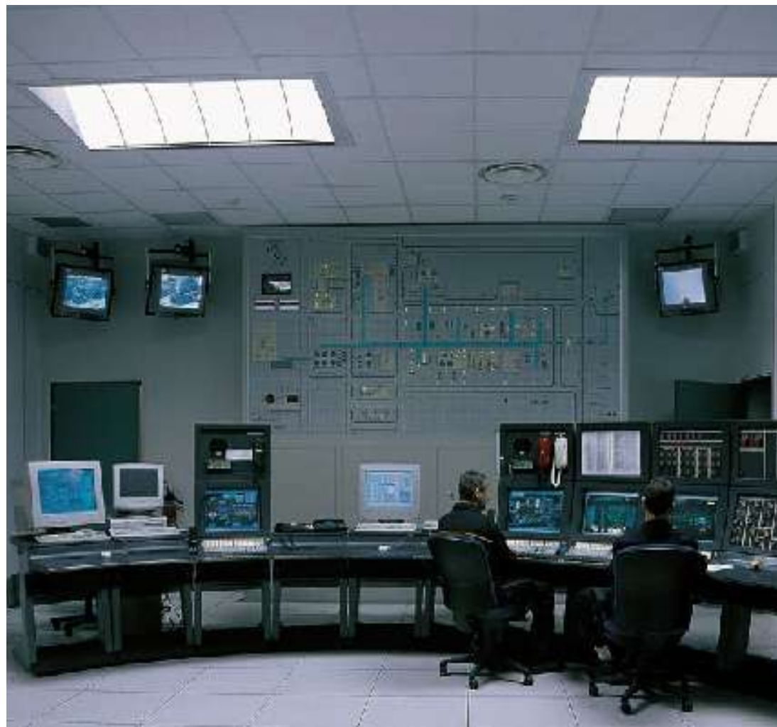
Sala di controllo Shell "Marsiglia": Prodotto utilizzato "Sivra"
